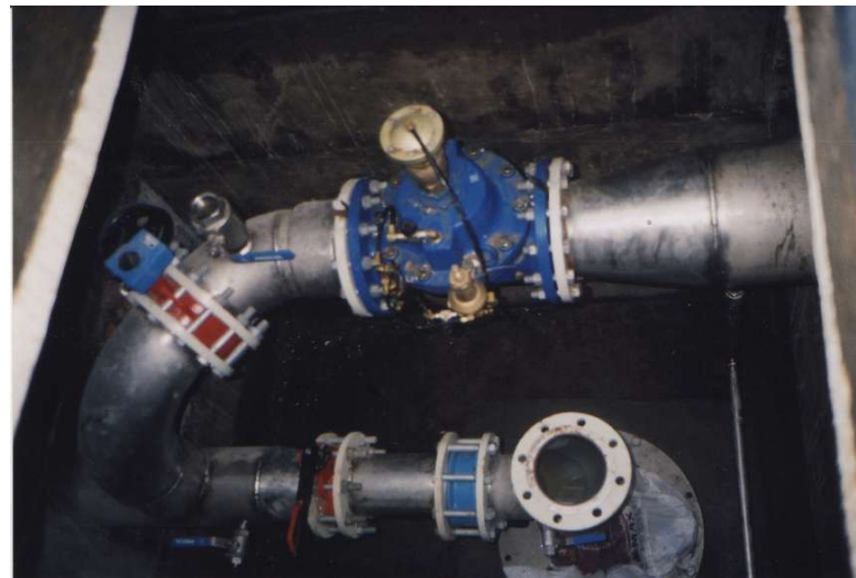
Водозабор – скважина с насосом
