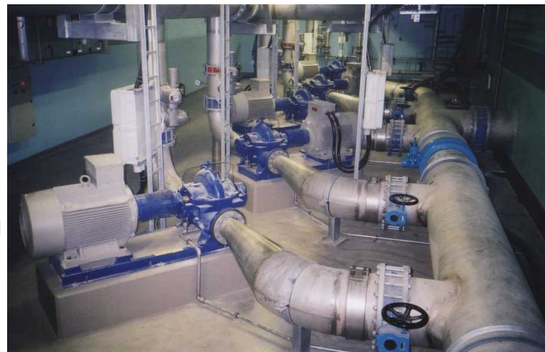
Станция очистки воды – машинный зал
