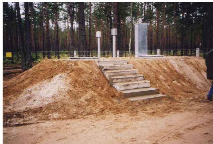
Водозабор – вид скважины снаружи
